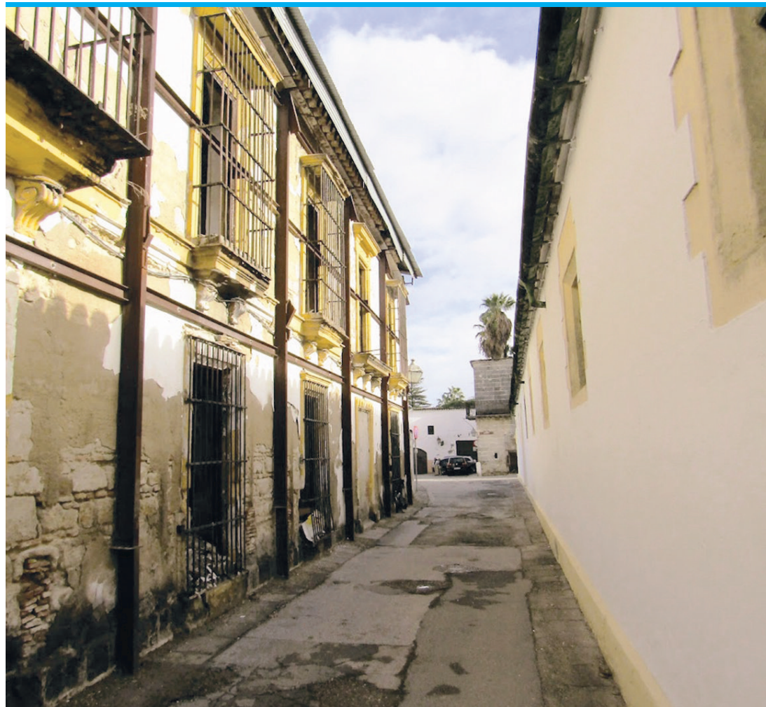
San Mateo, das „Weinviertel“ von Jerez: Verfall nahe der Star-Bodegas.
